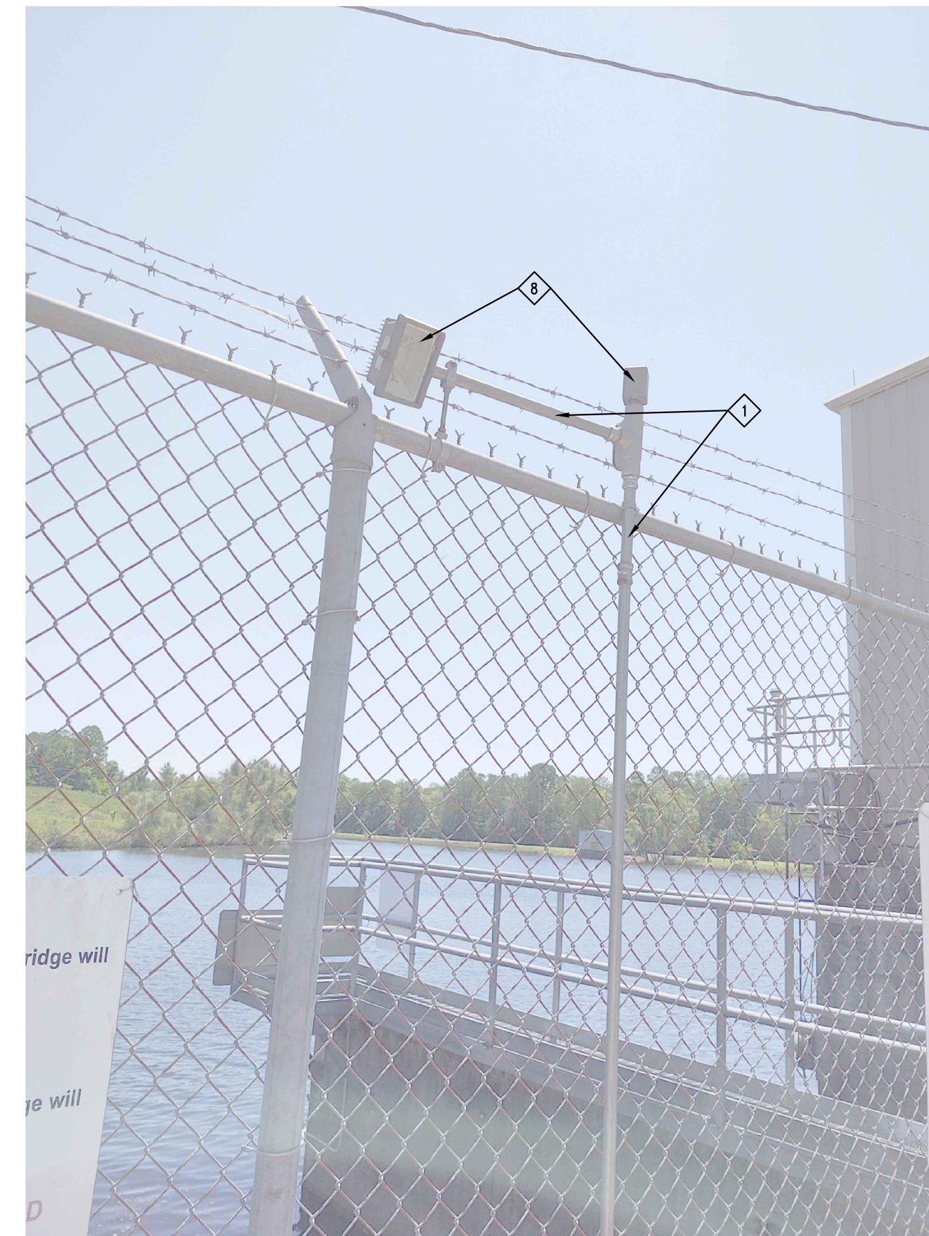
6 EXISTING PHOTOCELL AND FLOODLIGHT SCALE: N.T.S.
